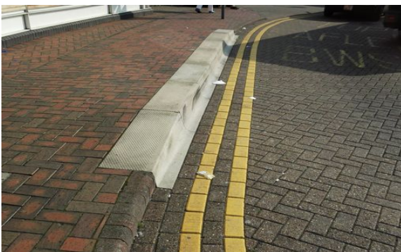
Figur Exempel på hållplats-kantsten för tät angöring med buss. (Kan vara Kassel-Curb)
